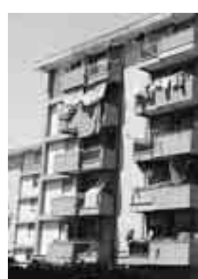
Uno degli immobili della zona del Belvedere in cui si sono verificati dissesti nelle scale e nel prospetto
